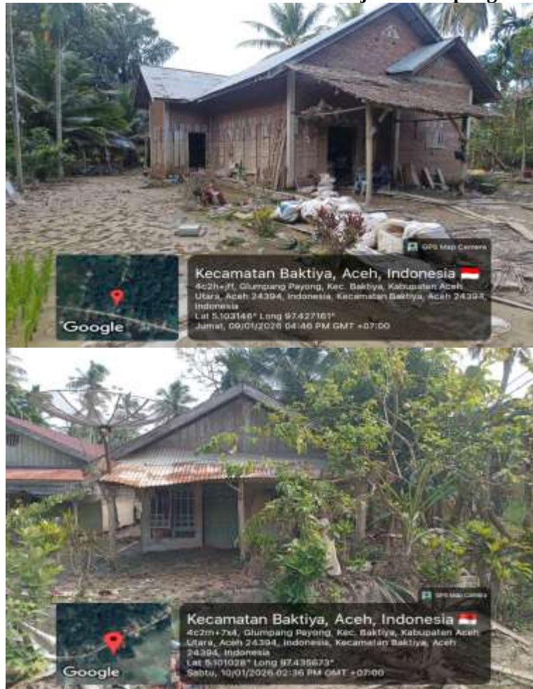
Gambar 3: Kondisi Kerusakan Rumah Pascabanjir di Gampong Glumpang Payong.
